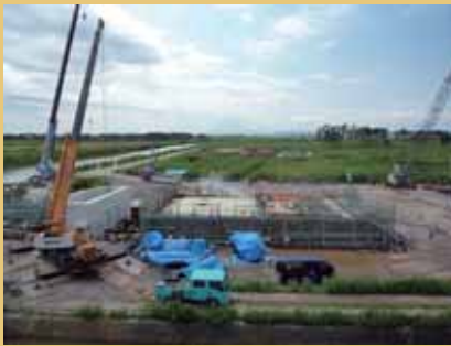
相の釜排水機場
