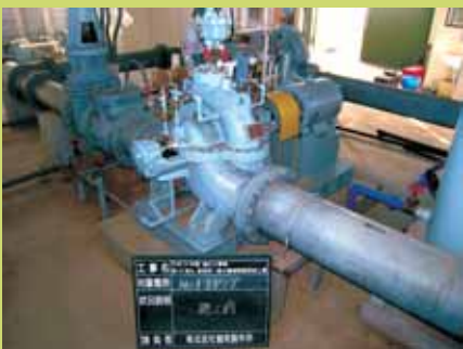
維持管理適正化事業（愛島第1揚水機場）
